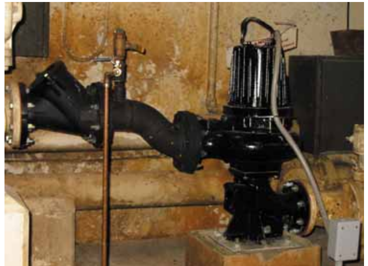
The new TWAS pump supplied by ITT Flygt.
