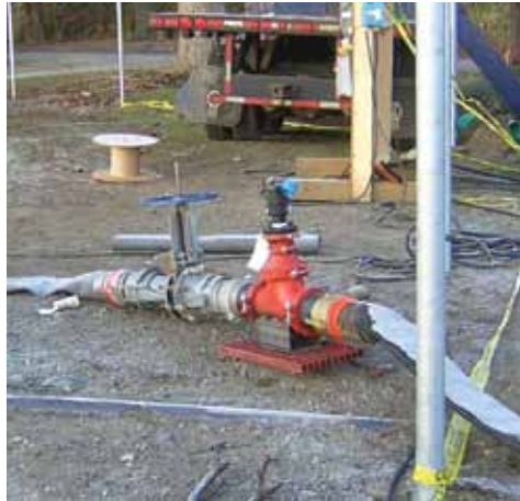
La valve combinée (vanne d'isolement et purgeur d'air) et un robinet-vanne de 6 po. pour gérer le débit.
