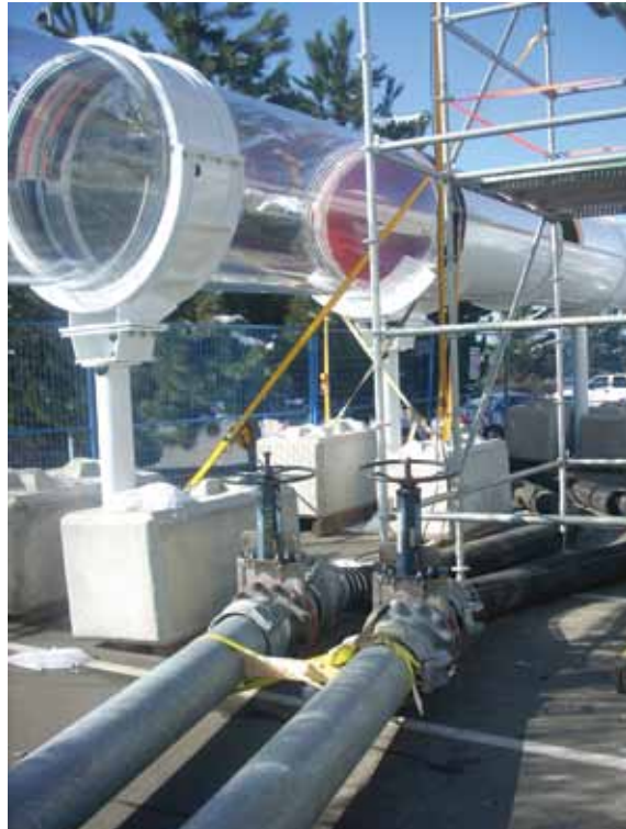
Robinets-valves de 12 po servant à réguler le débit.
