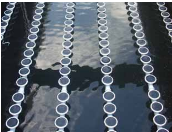
Système d'aération à fines bulles Sanitaire.
