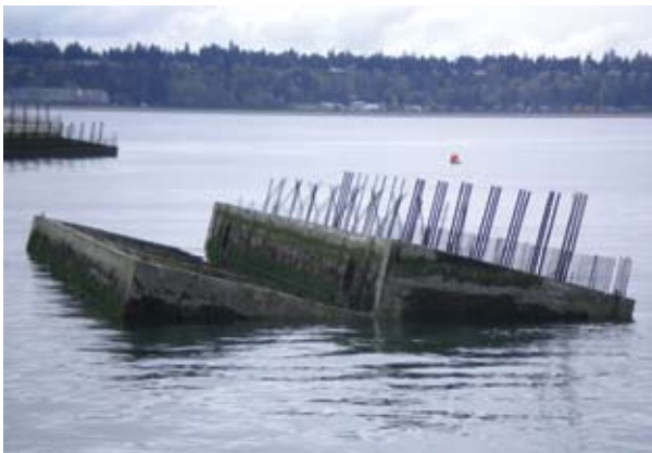
Un des six caissons partiellement coulés endommagés pendant la tempête.
