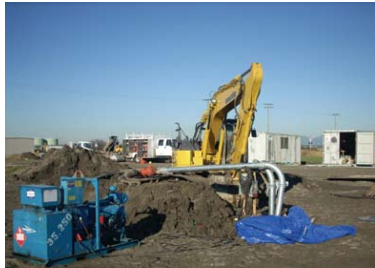
Génératrice de 35 kW Flygt, canalisations Bauer, clapets antiretour et deux pompes 3127 de 10 ch dans le puisard.
