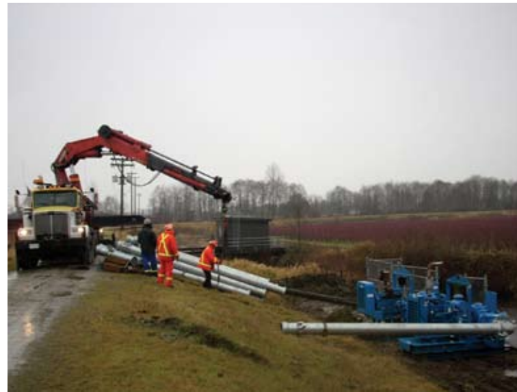
Une grue mobile est nécessaire pour installer les pompes entraînées par moteur diesel et les raccords de refoulement.
