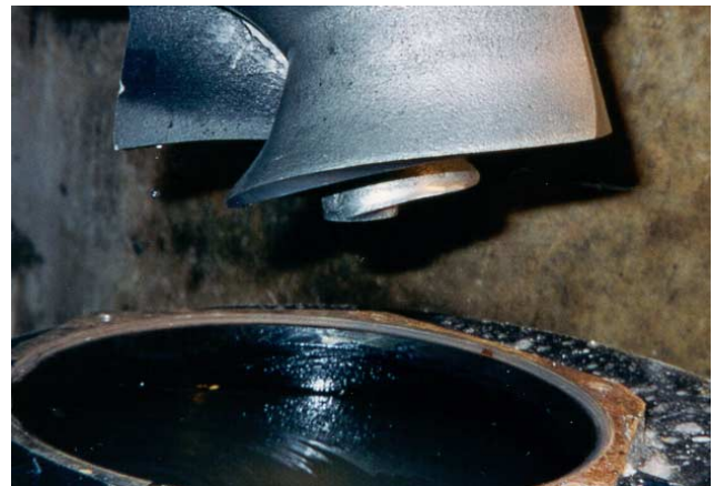
Impulseur sans colmatage de la pompe "N", après une période d'essai de trois mois.
