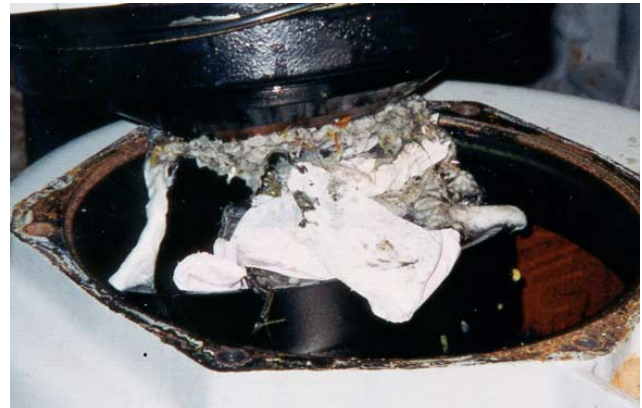
Impulseur colmaté de la pompe régulière, après la période d'essai.
