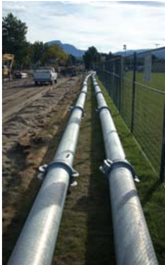
Conduites en acier de 12 po.
