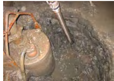
La Guzzla SV60 en service au niveau 4130 à CVRD Inco à Sudbury.
