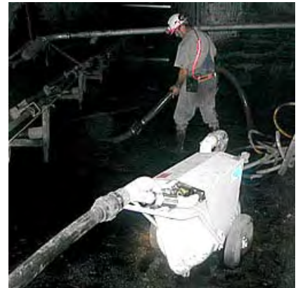
Une pompe mobile de transfert des solides Guzzla de modèle SV60 nettoyant des déblais sous la surface terrestre.
