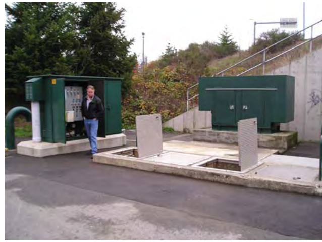
Emmet McCusker effectue une inspection périodique de la station.
