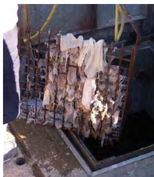
Une des grilles qui empêchent les matières solides de pénétrer dans la bêche d'aspiration
